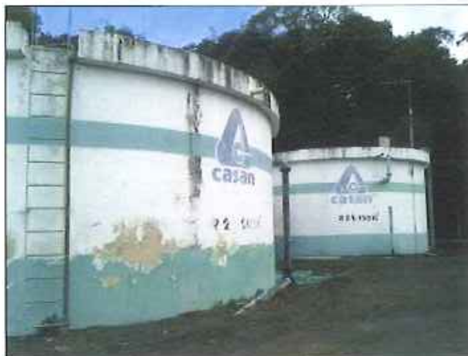
Figura 16: Reservatório R02.2A e R02.2B – 150 m 3 e 200 m 3 , respectivamente
