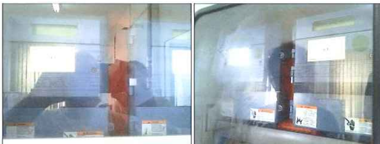
Figura 6: Macromedidores inoperantes (fevereiro de 2016)
