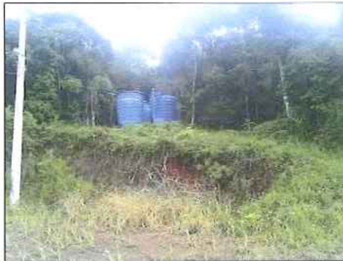
Figura 32: Reservatório Loteamento Industrial / Campina Bela – 25 m 3 cada
