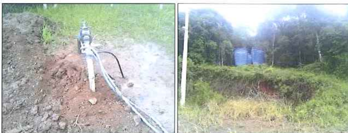
Figura 51: Poço Industrial / Campina Bela (à esquerda) e quatro reservatórios com capacidade de 25 m 3 cada (à direita)
