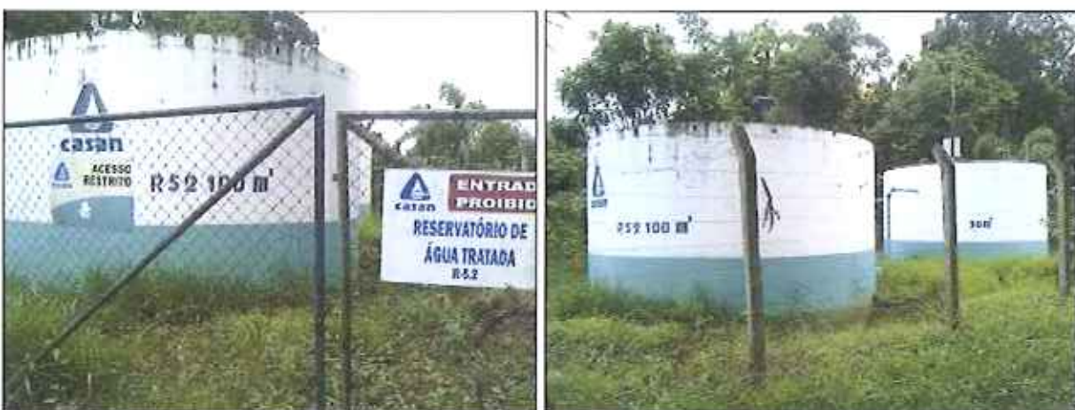
Figura 27: Reservatório R05.2 – 100 m 3 + 50 m 3
