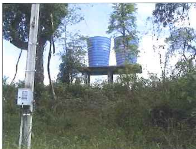
Figura 18: Reservatório R02.2.2 – 25 m 3 cada
