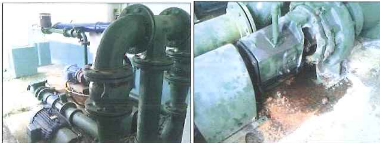
Figura 34: ERATs 03 e 04, junto à ETA, com vazamento
